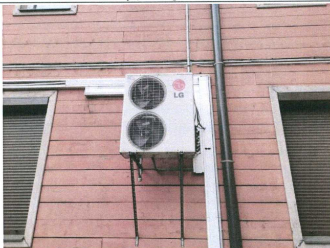
1.att. "Multisplit" ārējie bloki LG M30AH
